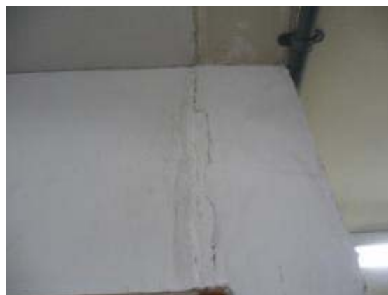
現業庁舎 : 内壁のひび割れ
