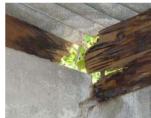
車庫 : 梁の腐食
