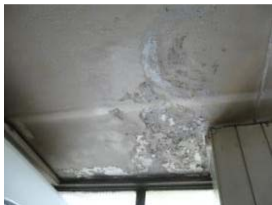
現業庁舎 : 漏水による天井モルタル塗の剥離、破損
