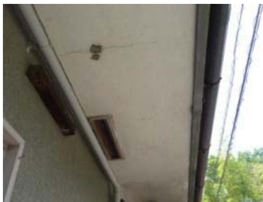
事務庁舎 : 軒天井モルタルの剥離、ひび割れ
