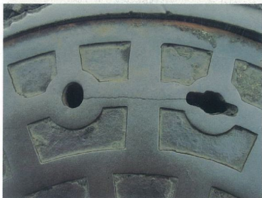
① ふたのクラック (Aランク)
