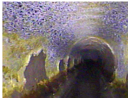
【ランクB】 骨材露出状態(HP、A市事例)
