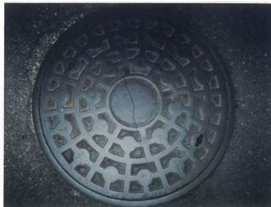
② ふたのクラック (Aランク)
