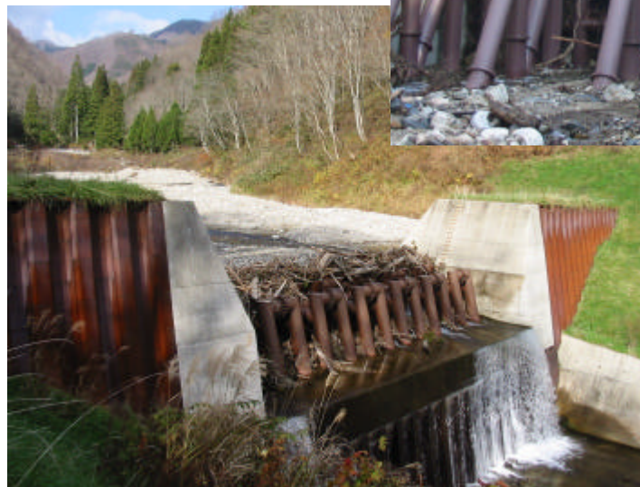
流木を捕捉した二ッ屋谷えん 堤 (飛騨市宮川町)
