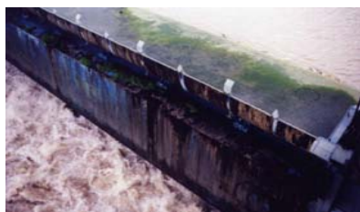
ゲート扉体の腐食
