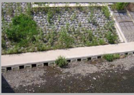
機能しない魚巣ブロック
