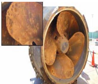
排水ポンプの腐食
