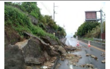
写真1 法面崩落状況（串本町和深地先）
