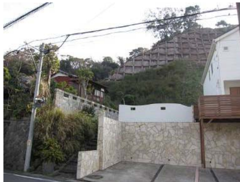
暗褐色仕上げたコンクリート擁壁 (鎌倉市長谷極楽寺地区)
