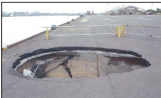
【岸壁エプロン陥没】
