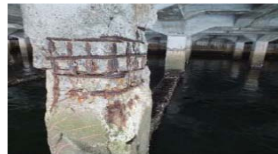
【栈橋脚柱部鉄筋露出】
