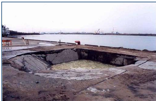
【岸壁エプロン陥没】
