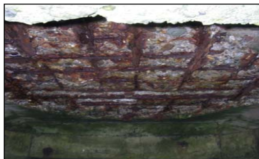
【栈橋床版下面鉄筋露出】
