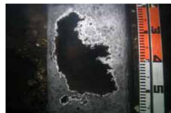
【腐食による 鋼矢板開孔】
