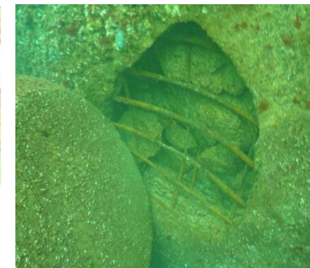
防波堤側壁孔空き
