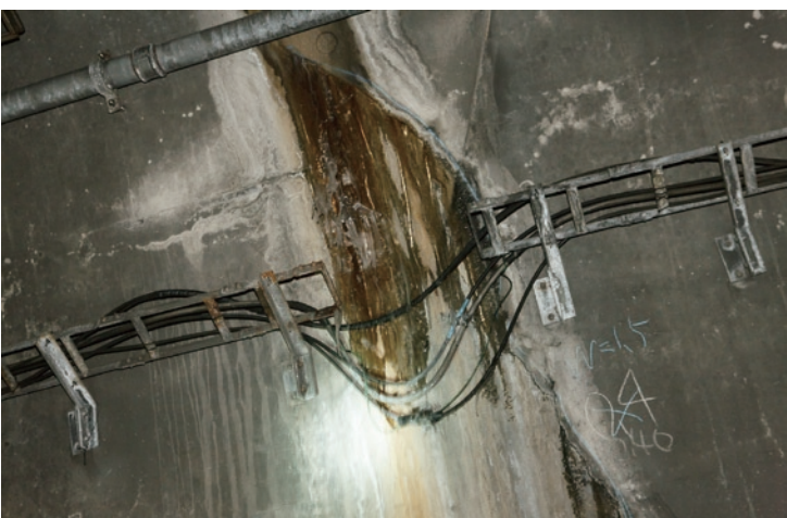
トンネル壁面はコンクリートの継ぎ目からの漏水が激しい。(平成26年2月撮影)
