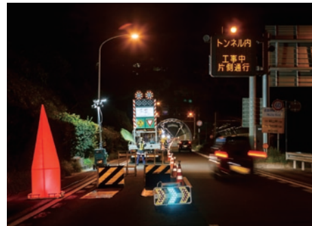
下りのトンネル入口付近の様子。下り線はスピードを出す車が多いため、表示を派手にして車止めも二重に設置。(平成25年11月撮影)
