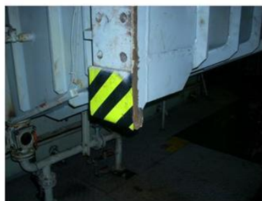
衝突防止の緩衝材
