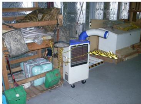
作業中の暑さをやわらげるスポットクーラー
