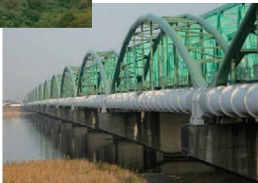
農業用水・都市用水を運ぶ 水管橋 (木曾川用水)
