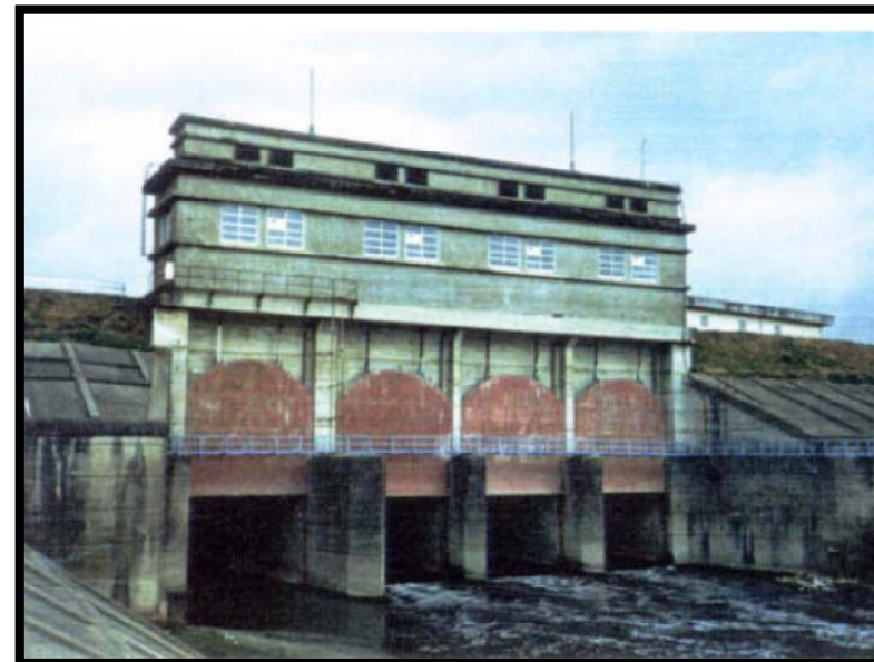
樋門の老朽化
