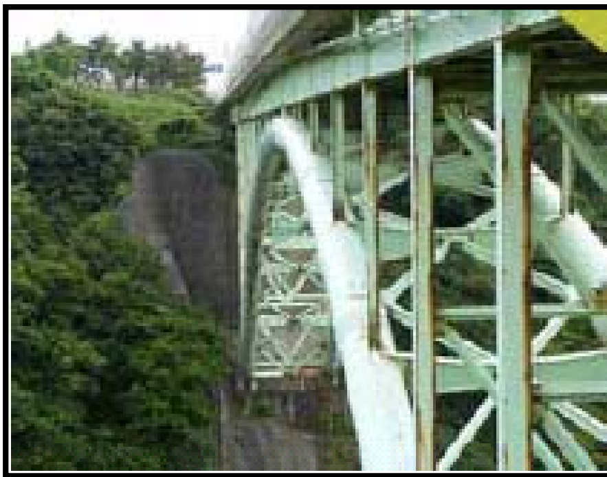
アーチ橋の腐食状況
