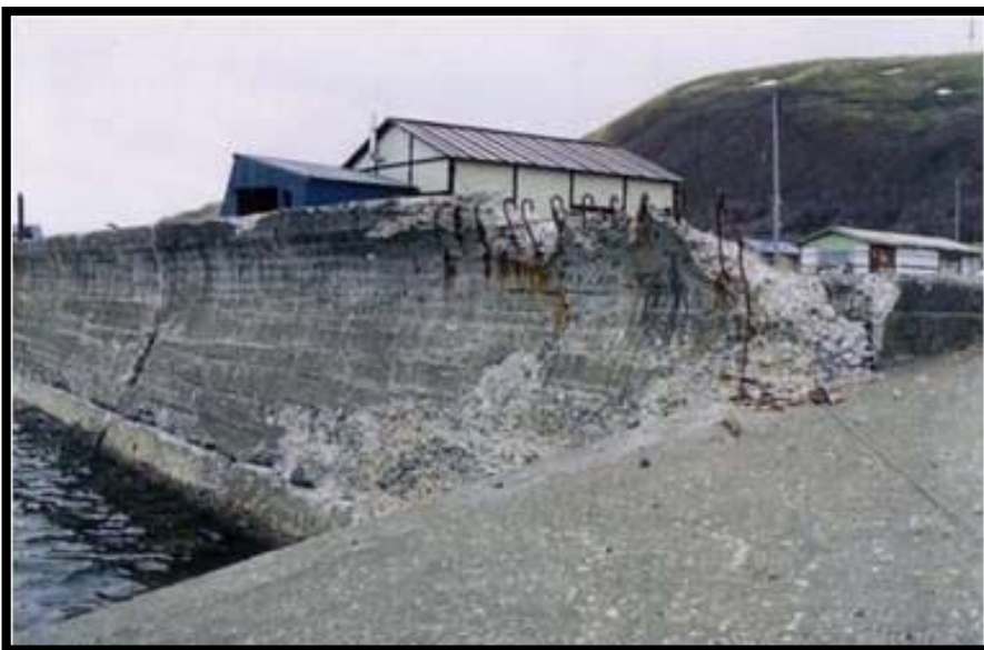
老朽化した海岸堤防
