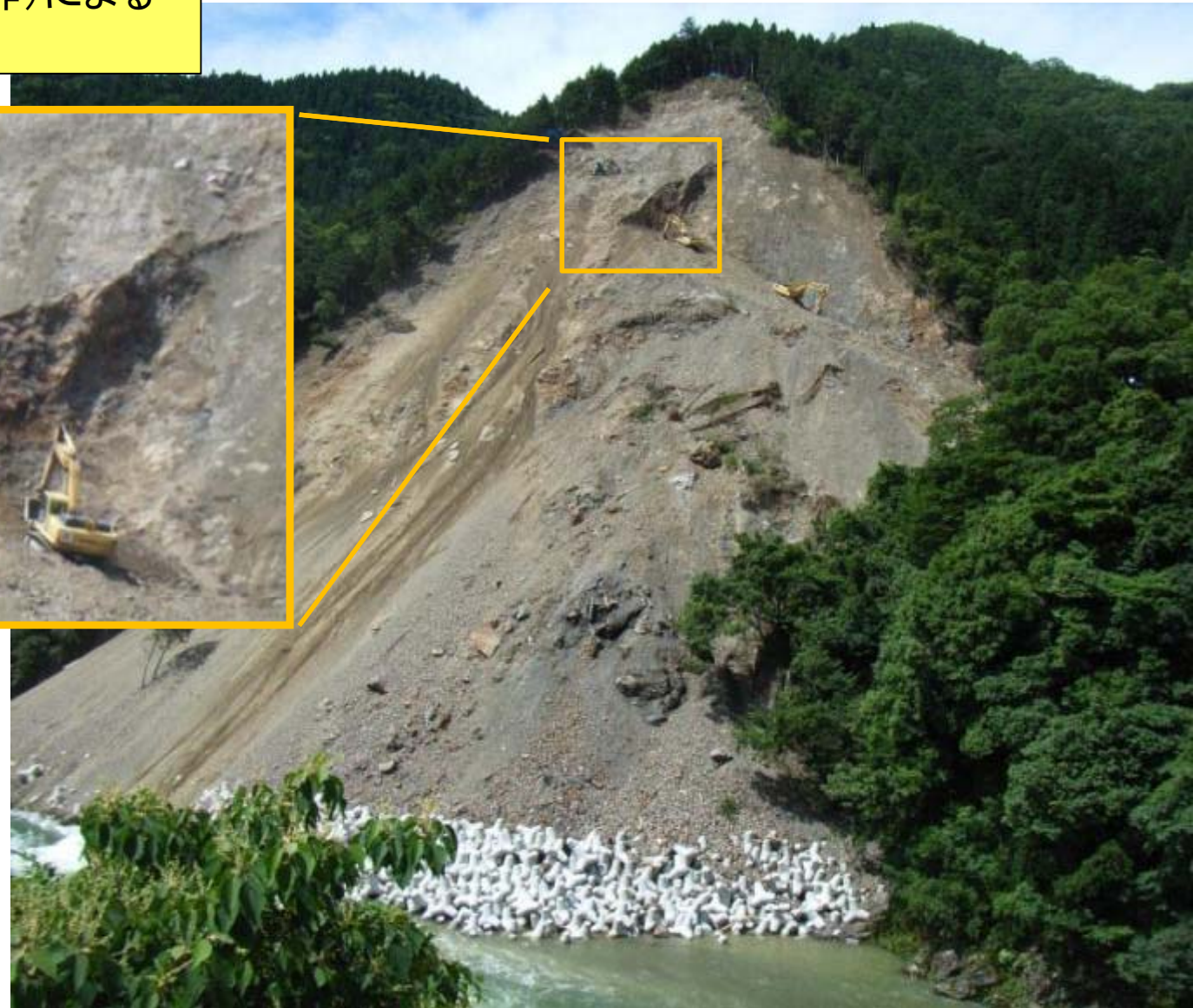
揖斐川町東横山地内地すべり(中部地方整備局H18.5) 資料-2
