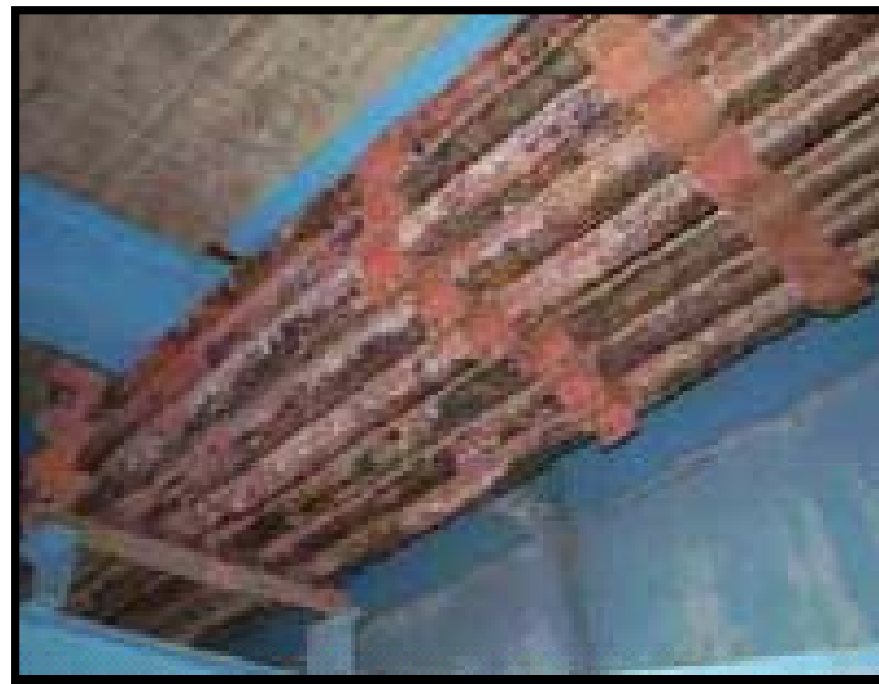
橋梁下面の添架物の腐食
