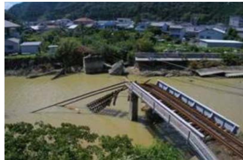
JR橋梁被災状況
