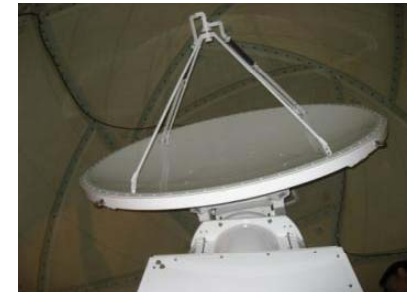
レーダアンテナ(埼玉サイト)
