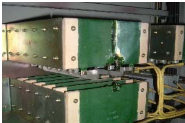
劣化により発熱溶解したホーロー製抵抗器
