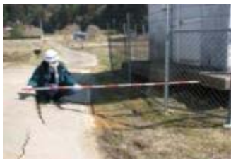
サイホン上部の沈下状況
