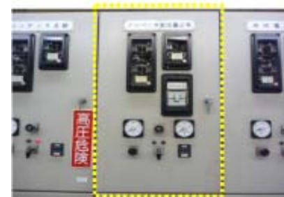
インバータ変圧器2号盤
