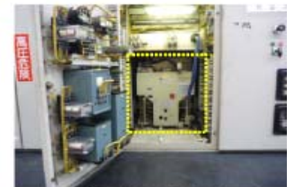
盤内部(他の真空遮断器実装)
