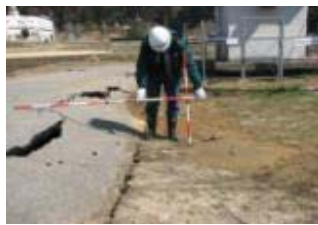
サイホン上部の沈下状況
