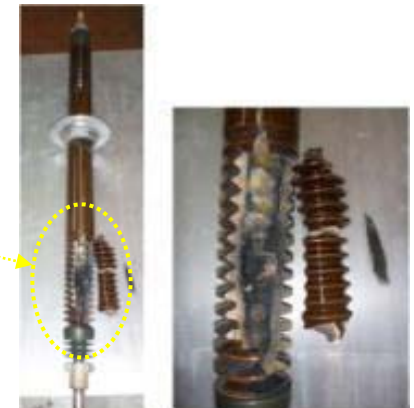
※原因は部材の劣化と考えられる
