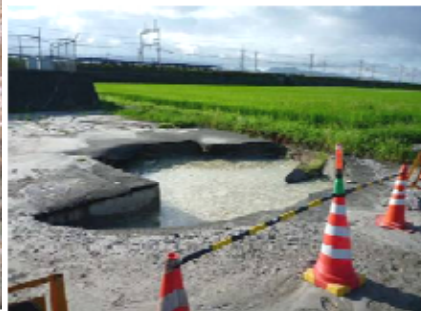
漏水による排泥工周辺陥没状況
