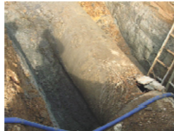
漏水箇所の状況
