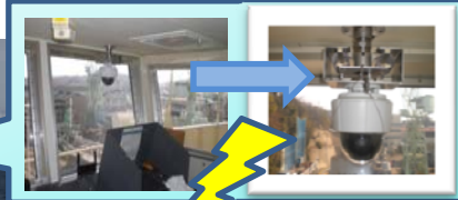
ブリッジに備え付けられたライブカメラ
