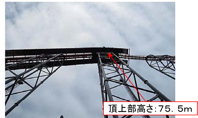
写真2. ボルト落下推定位置より上方視
