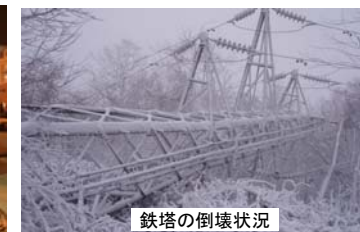
鉄塔の倒壊状況
