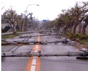
＜電柱の倒壊による道路閉塞＞
