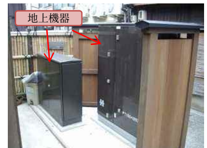
民地を活用した地上機器の設置
