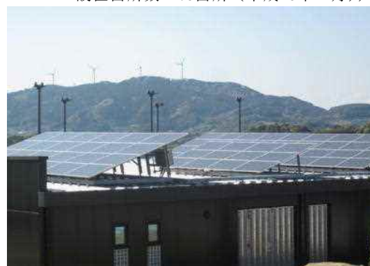
＜太陽光発電設備の整備＞ (新東名高速道路 浜松SA (上り線))
