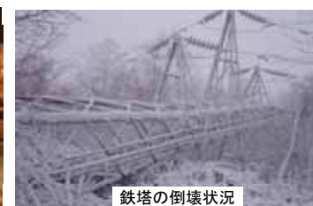
鉄塔の倒壊状況
