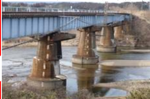
大野・双葉駅間第一前田川橋りょうの落橋（震災後）
