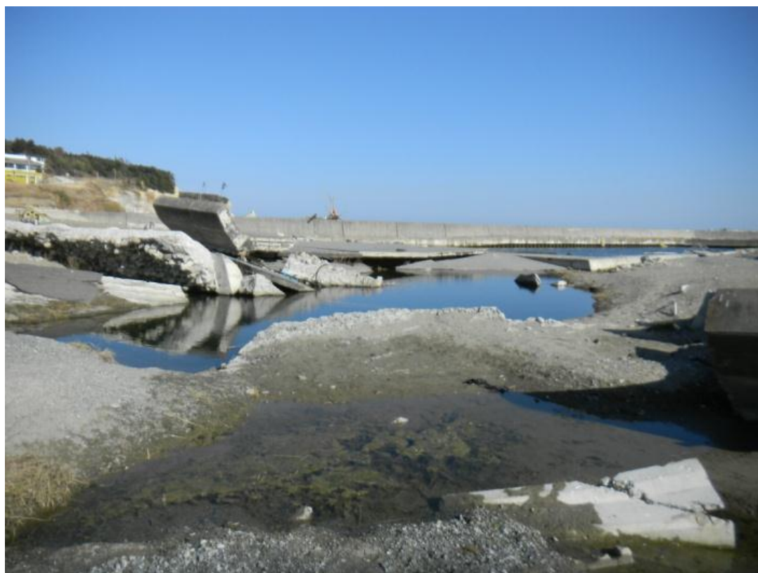
① 海岸堤防の破堤
