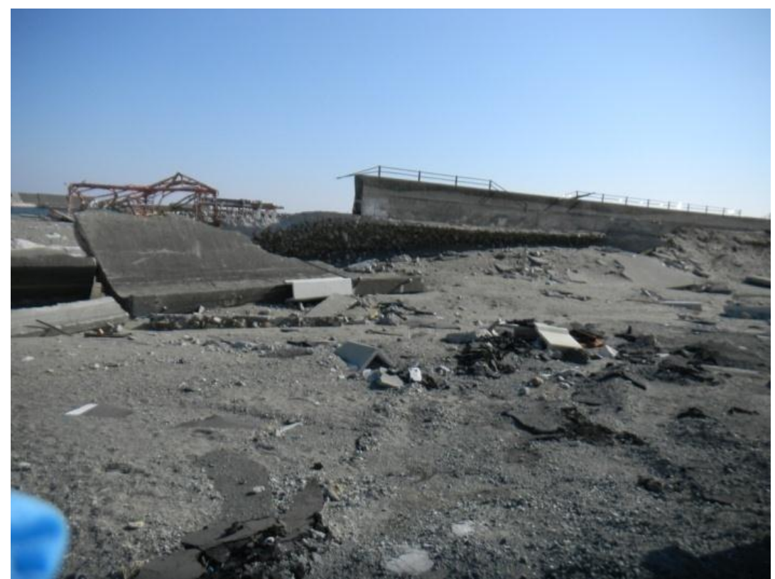
② 海岸堤防の破堤
