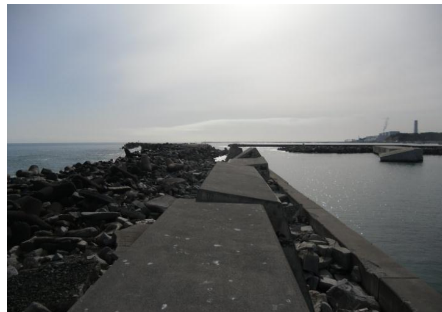
① 破堤した東防波堤
