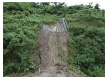
写真1 国道3号の法面崩壊状況
