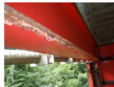
・B判定(腐食)
