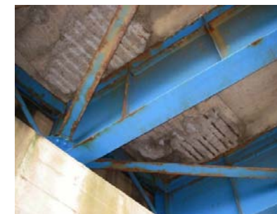
・C判定(剥離・鉄筋露出)
