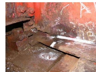
・E判定(腐食・亀裂)
