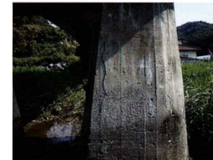
下部工の損傷状況(ひびわれ)
