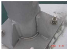
金属疲労による損傷事例
