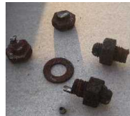
吊ボルト折損
