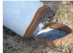
腐食による損傷事例
