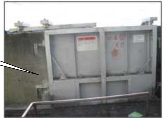
陸閘の常時閉鎖化
