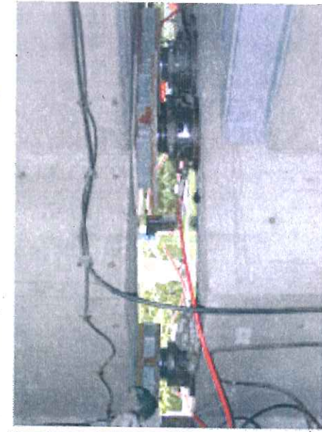
(株)竹中工務店「船橋竹友寮積層ゴム取り替え施工報告書」より
