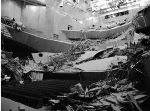
ホール天井の脱落
