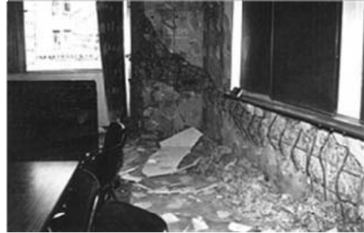
内部の被災状況
