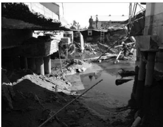
庁舎周囲の地盤流出
