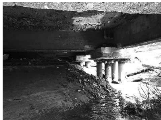
建物基礎が露出
