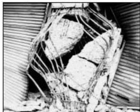
店舗1階柱の圧壊
