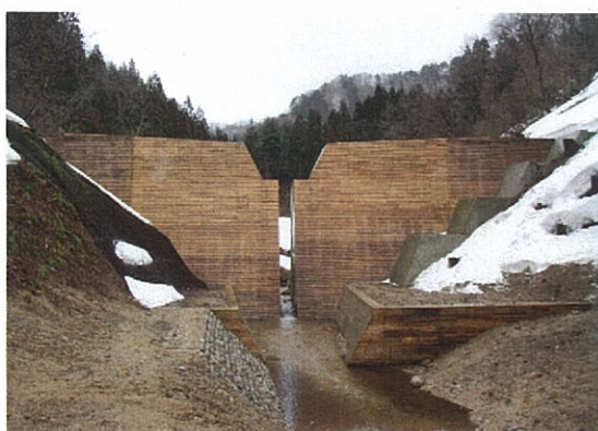
🌲 勝木川水系大林沢砂防ダム残存型枠(河川事業)
