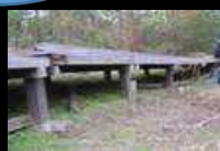
壊れかけたウッドデッキ
