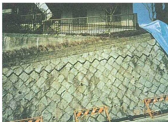
図Ⅶ. 3. 3 擁壁の沈下例 2
