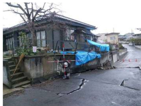
b) 宅地擁壁の崩壊
