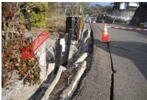
a) 盛土頭部のクラック
