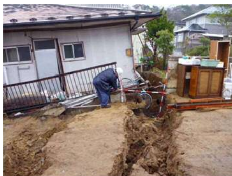
a) 宅地地盤のクラック
