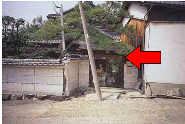
図参 1.1-④ 西宮市における盛土造成地の変動に伴う被害（その 1）
