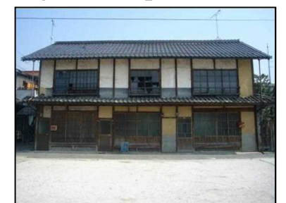
窓が割れ、放置されている空家
