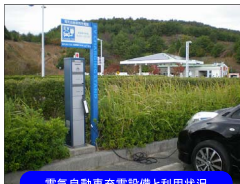
電気自動車充電設備と利用状況
