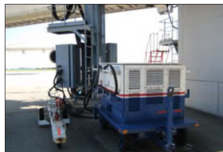
GPU(地上動力設備)4台配備
