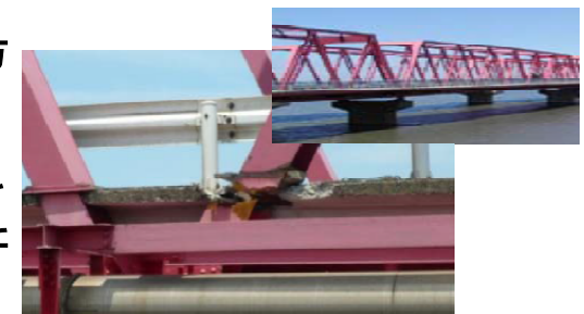
トラス橋斜材のコンクリート埋込部の腐食破断
