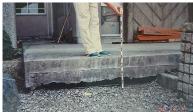
建物の被害状況
