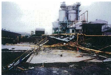
C製鉄所のパイプライン被災状況
