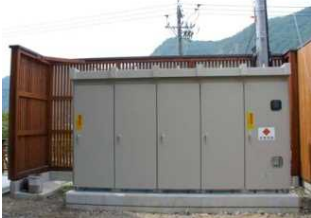
非常用発電機
