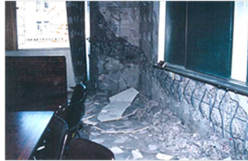
内部の被災状況
