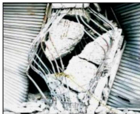
店舗1階柱の圧壊
