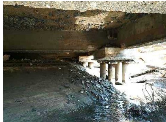
建物基礎が露出
