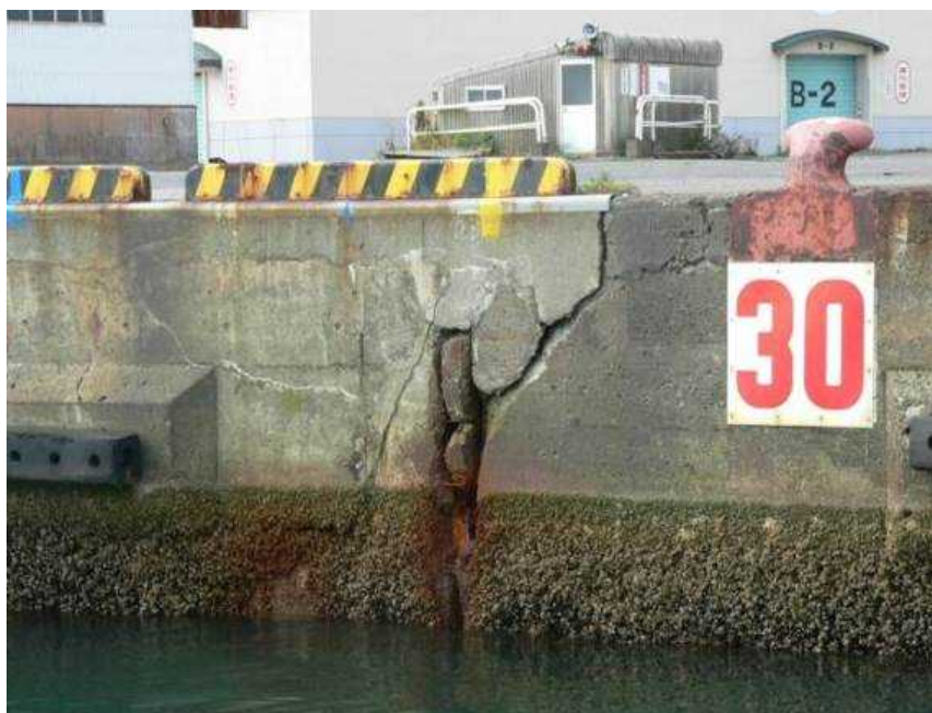
図－9 耐震強化岸壁の老朽化事例
