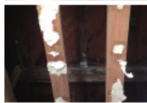
雨漏れによる被害、カビの発生や家全体の腐食の原因になります
