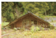
放棄が続き続いた空き家は傾斜の危険性も・・・
