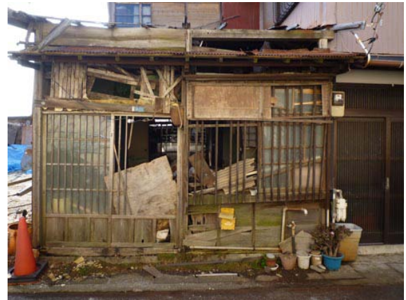
写真4 廃屋状態の空き家
