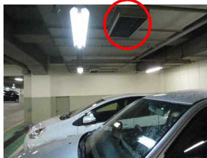
②給気ダクト及び吹出口
