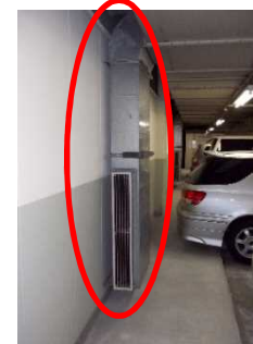
③排気ダクト及び吸込口
