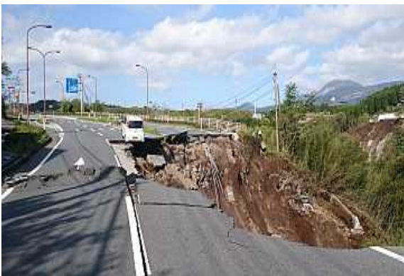
阿蘇大橋地区斜面崩壊(国道57号熊本側)
