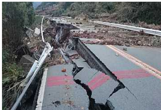
阿蘇大橋地区斜面崩壊(国道57号大分側)
