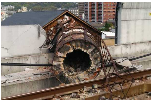
沿線の煙突倒壊による防音壁損傷 (新玉名～熊本間)
