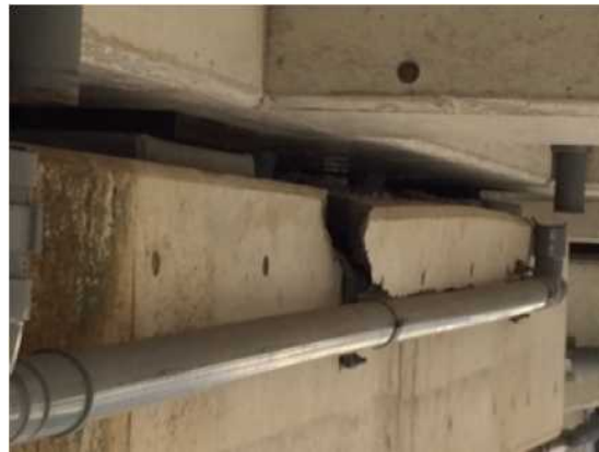
桁ズレ(支承部損傷) (新玉名～熊本間)
