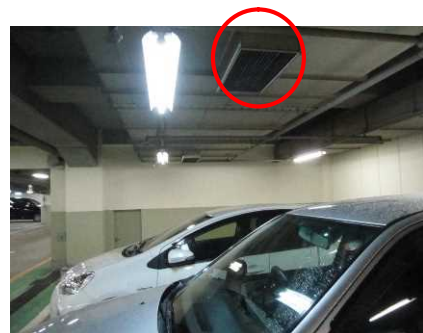
②給気ダクト及び吹出口
