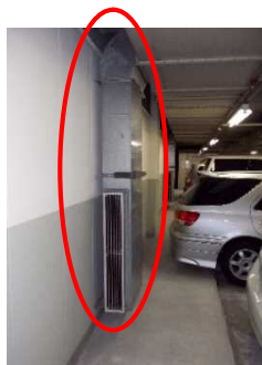
③排気ダクト及び吸込口
