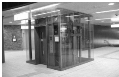
エレベーター
