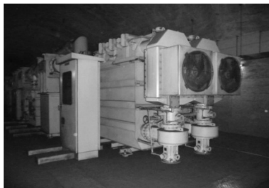
【変電所設備の例】
