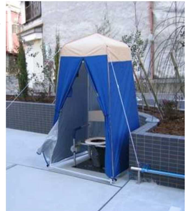
マンションに整備されたマンホールトイレ 大阪市HPより
