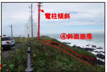
電柱傾斜 ④斜面崩落 南側斜面の法面崩落状況 【平成28年8月23日 撮影】
