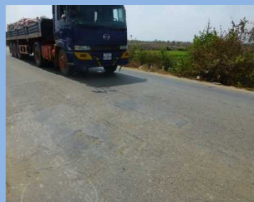
過積載車両の通行により 破損状況が深刻化
