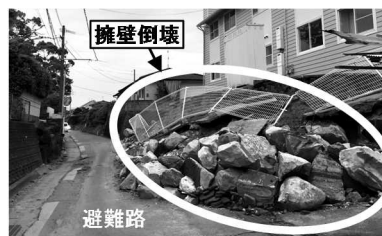
小規模造成宅地の被害
