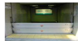
【地下鉄駅の止水版 による浸水対策】
