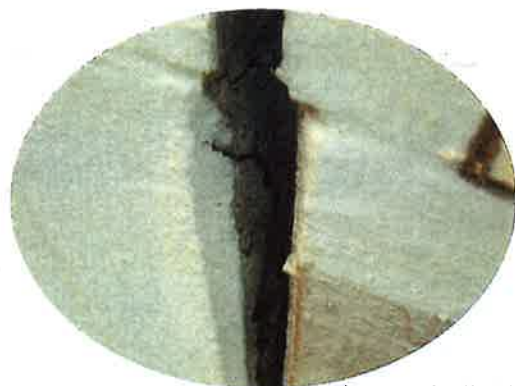
ブロック損傷状況
